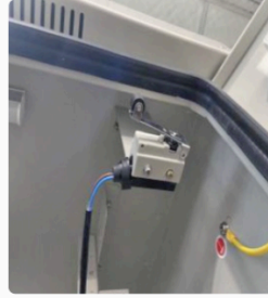
Door limit sensor
